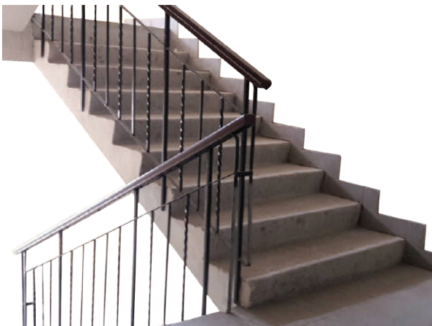
Ограждения лестничных маршей
